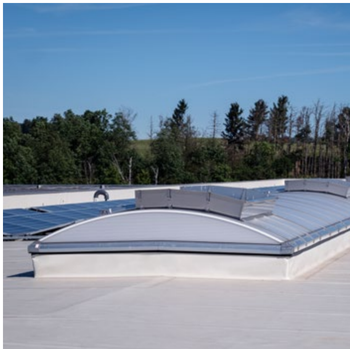
Lucernario Continuous Rooflight B de LAMILUX en la nave industrial de Bang Kransysteme en Oelsnitz
